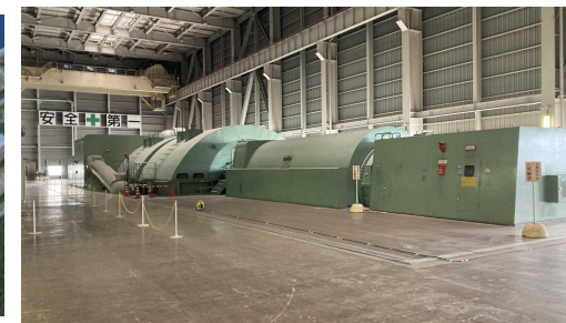
能代火力発電所 1号機の蒸気タービンと発電機
